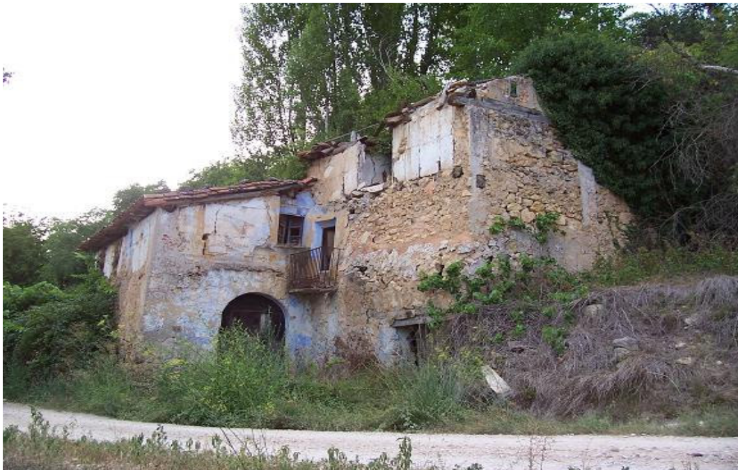
Molino de la Villa. Vallanca. Finales del siglo XVI. Este edificio conserva en gran medida su aspecto original, si bien necesita de una urgente y cuidadosa restauración.
